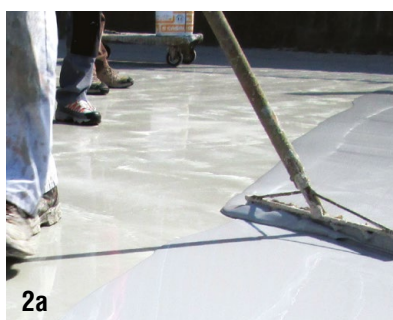
2a. Dettaglio applicazione con racla calibrata (vedi pag. 63) 2b. Posa dell'autolivellante impermeabile e carrabile POLYROOF
