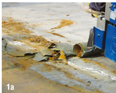
1a. Rimozione del fondo esistente 1b. Solaio di copertura carrabile da impermeabilizzare con sistema non-demolitivo POLYROOF
